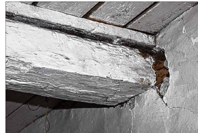
Die Feuchtigkeit hat dem Holz zu schaffen gemacht. Dieser Balken ist bereits weggefallen und wird bald ersetzt.
