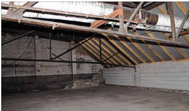
So sieht der künftige Ausstellungsraum im Obergeschoss der Hütte gegenwärtig aus. Die alten Heizungsrohre sollen im Zuge des Innenausbaus entfernt werden.
