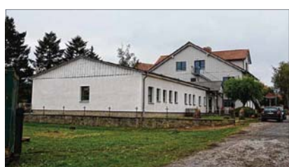
Für den neuen Anbau an die Kindertagesstätte in Darlingerode ist Baufreiheit geschaffen worden. Einige Obstbäume mussten weichen, die Zaunfelder am Vorgarten sind abmontiert. Foto: Regina Urbat
